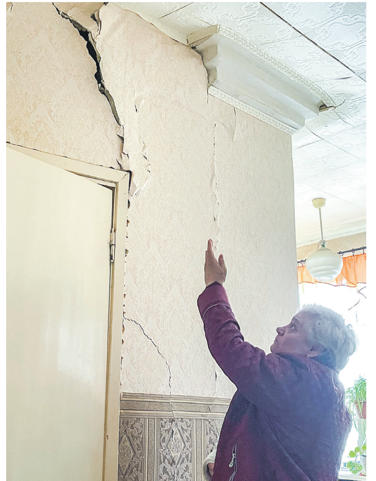
Надежда Дружинина показывает трещины на стене
